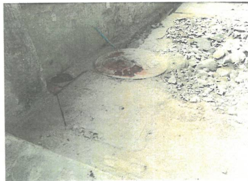
Fot. 8. Studzienka technologiczna znajdująca się w budynku przy ul. Sienkiewicza 14 w Zgierzu. Na pokrywie studzienki widoczne zarudzenie farbami.
