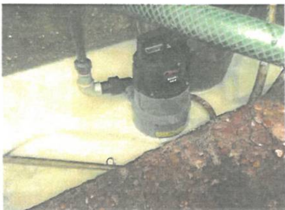
Fot. 5. Na fotografii widoczna pompa odpompowująca wodę do mauzera zlokalizowana w pomieszczeniu „przygotowanie farb”
