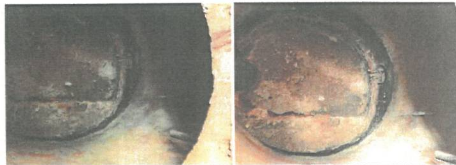
Fot. 9,10. Studzienka technologiczna znajdująca się w budynku przy ul. Sienkiewicza 14. Wnętrze studzienki zabrudzone farbami, dno studzienki suche.
